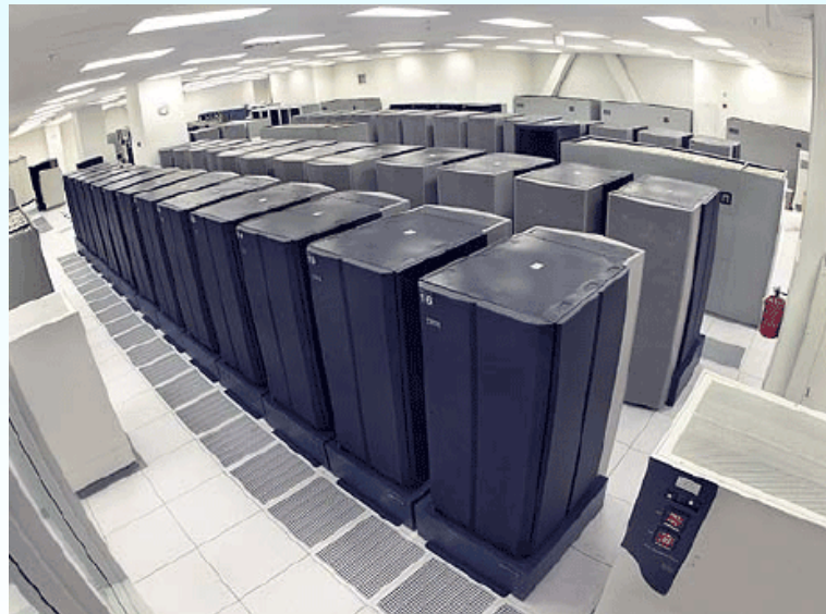
1 MW Data Center
